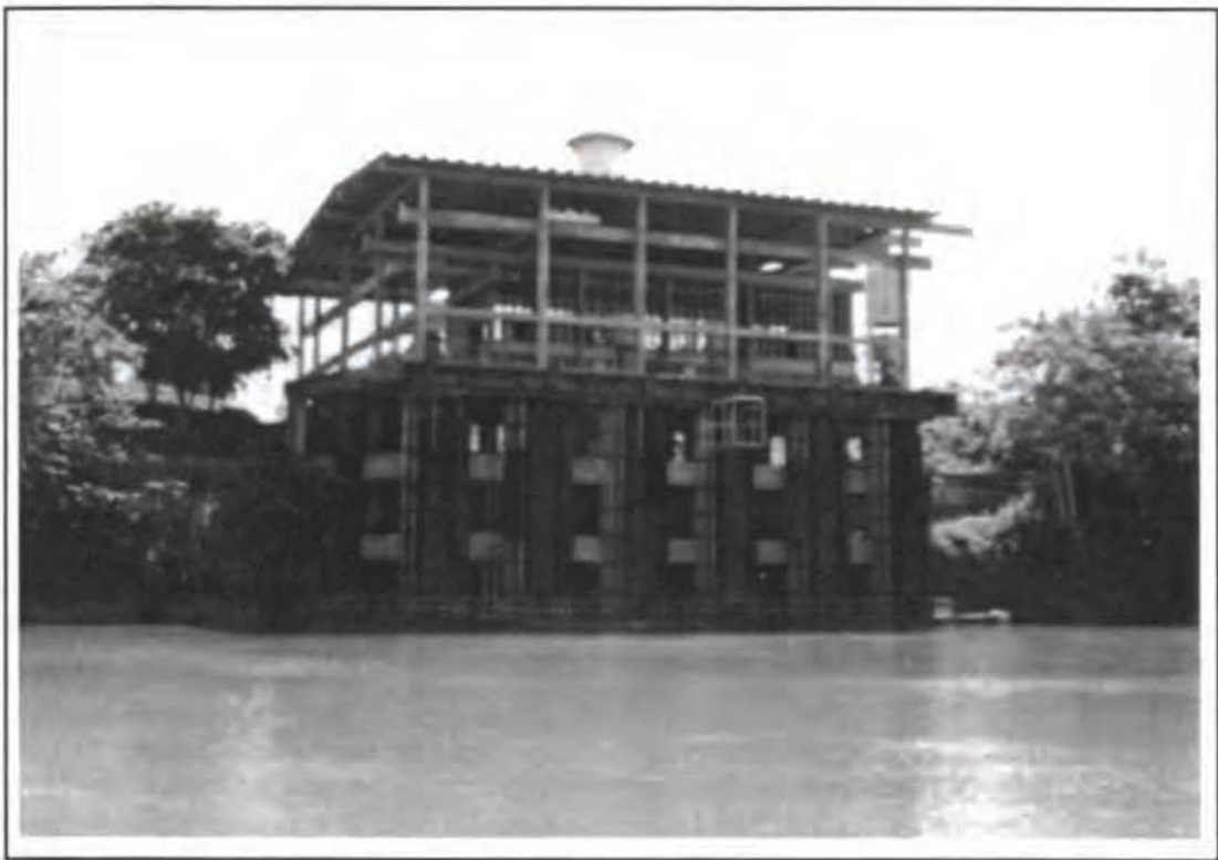
Foto 6 - Sistema de captação de água da CAEMA no rio Itapecuru, para abastecimento de São Luís - Município de Rosário.
