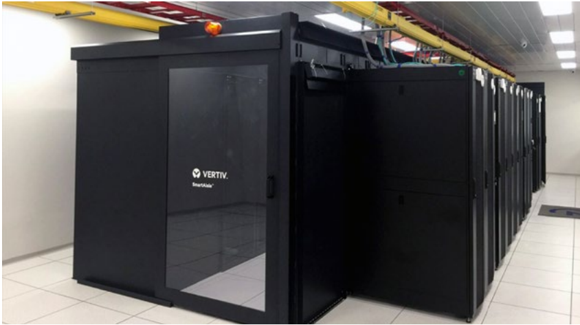
Módulos do data center do IBGE utilizado no processamento dos dados do Censo Demográfico 2022
